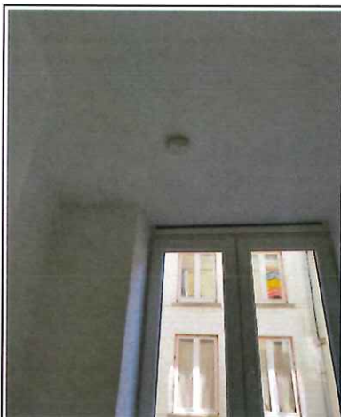
Foto 9: Rookmelder eerste verdieping
